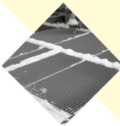
Рис. 2. Состояние ходового мостика из решетчатых настилов.
